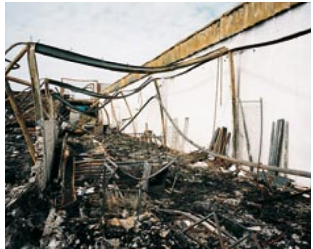
De smeltankers zijn bezweken aan de brandzijde, en de staalconstructie is ingestort zonder de brandwand mee te sleuren.
