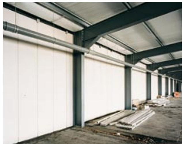
Aan de andere kant van de brandwand zijn de smelttankers intact gebleven: de brandwand heeft zijn functie vervuld.
