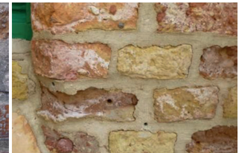
figuur 11. Detail van de gevel in cementmortel van de Onze-Lieve-Vrouw ter Duinenkerk in Oostende (1929).
