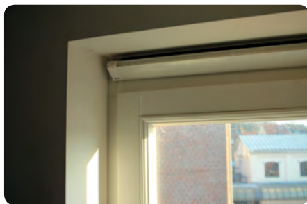
Luchttoevoer via luchtverser tussen raam en bovendorpel
